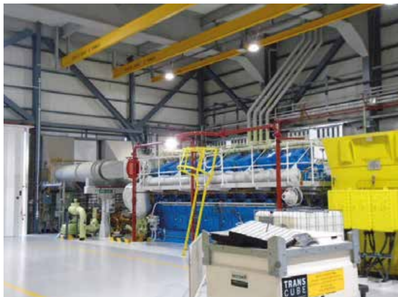
Diesel de secours, centrale AGR
