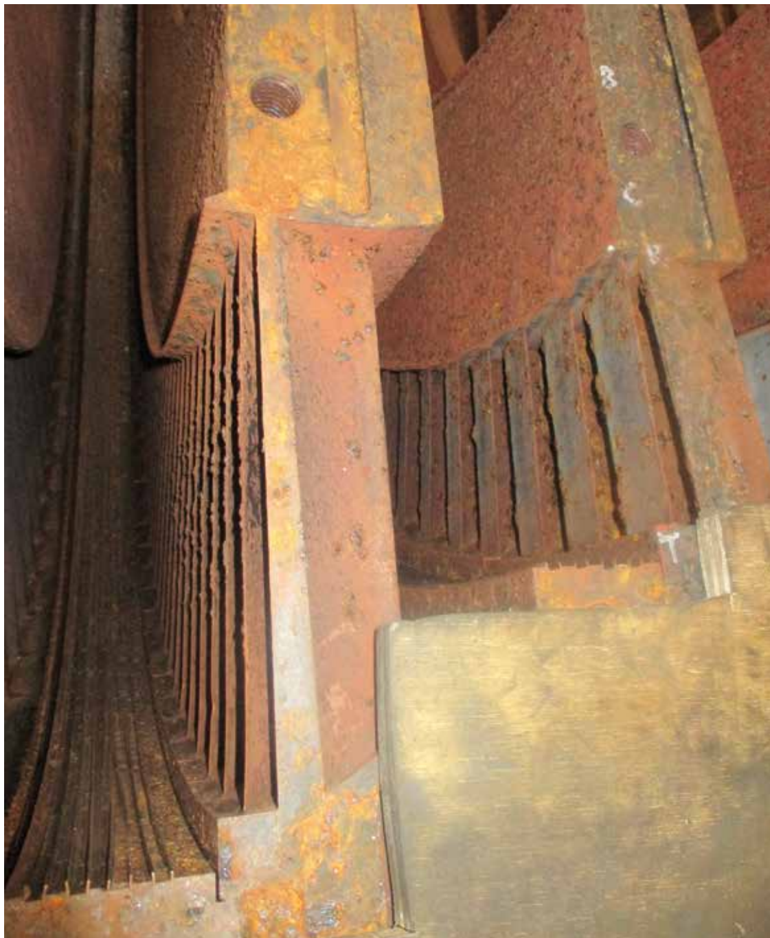
Corrosion d'aube de turbine
