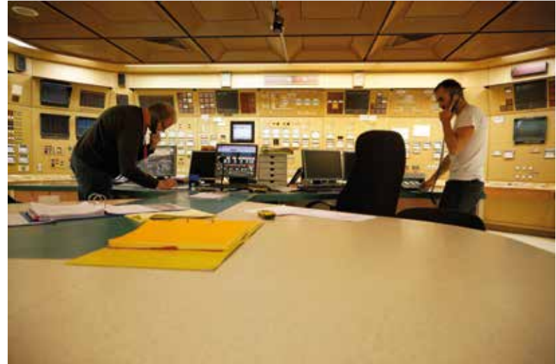
Salle de commande de 1300 Mwe
