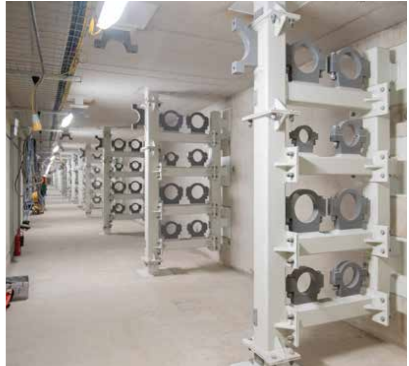
Support de tuyauteries en galerie, Hinkley Point C
