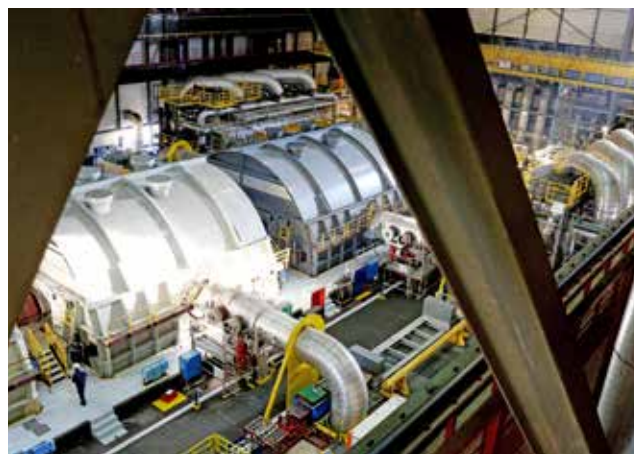
Salle des machines
