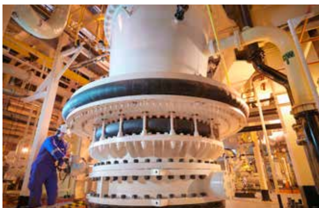
Manœuvre de vanne
